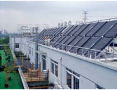
宝钢发展公司下属物流公司的屋顶太阳能热水系统
